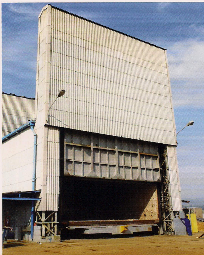
▼ Forno externo para tratamento térmico (20m de comprimento, 10m de altura, 10m de largura e 1200°C)
